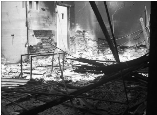
Niedergebranntes Schulgebäude der Missionsstation Surumu
