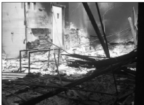
Niedergebranntes Schulgebäude der Missionsstation Surumu
